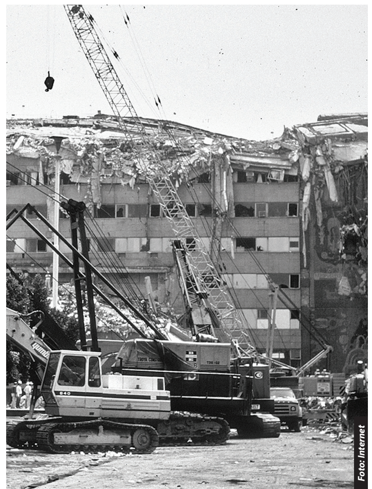
México, D.F.: Edificio de la Secretaría de Comunicaciones y Transportes colapsado en sus últimos pisos en el terremoto del 85. Maquinaria pesada trabaja en la reconstrucción del inmueble.
