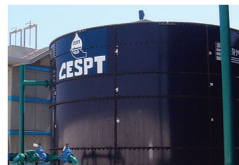
Planta de Tratamiento CAR UABC
