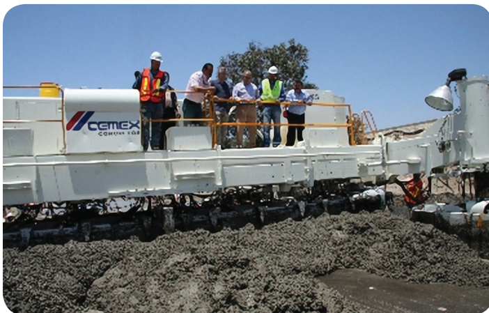
Jorge Ramos y Osuna Millan supervisan las obras viales en Tijuana. Foto tomada de Tijuana 2010, Blog de Wordpress.
